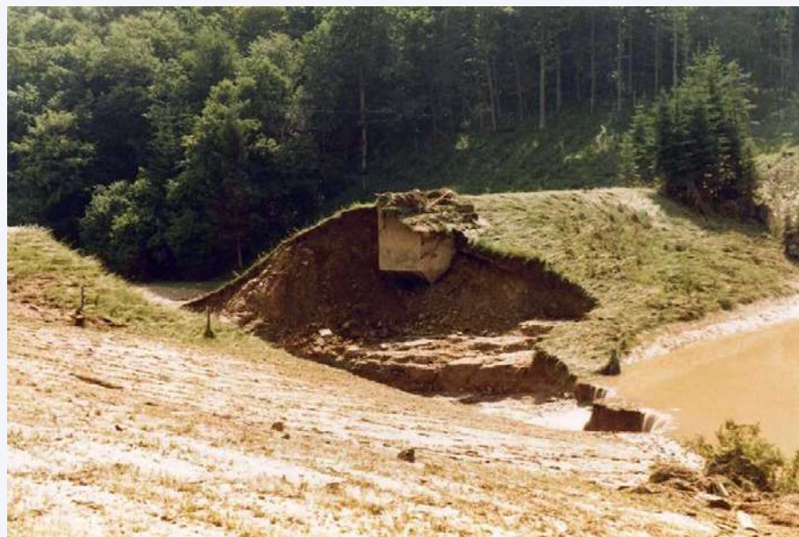
Bruch eines Dammbauwerkes im Jahr 1984, Hochwasserrückhaltebecken der Gemeinde Königheim (Baden-Württemberg)
